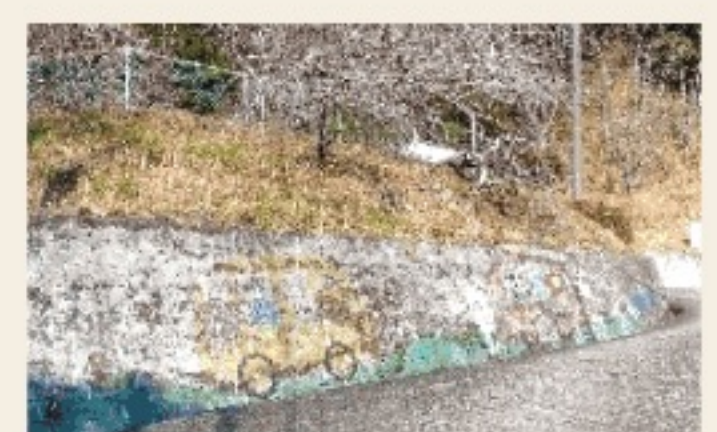
現在は残念な汚れた擁壁
